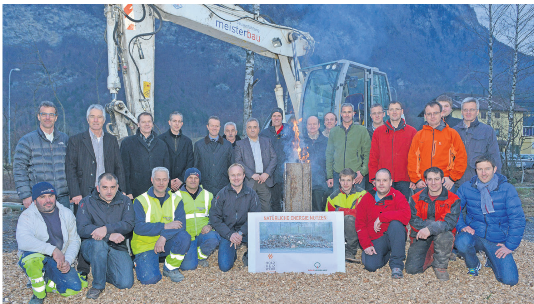
Die Bürgergenossenschaft Balzers, Forstware sowie Vertreter von Gemeinden und Abnehmern feierten gestern den Spatenstich für das Holzheizwerk. (Foto: Vollmar)
